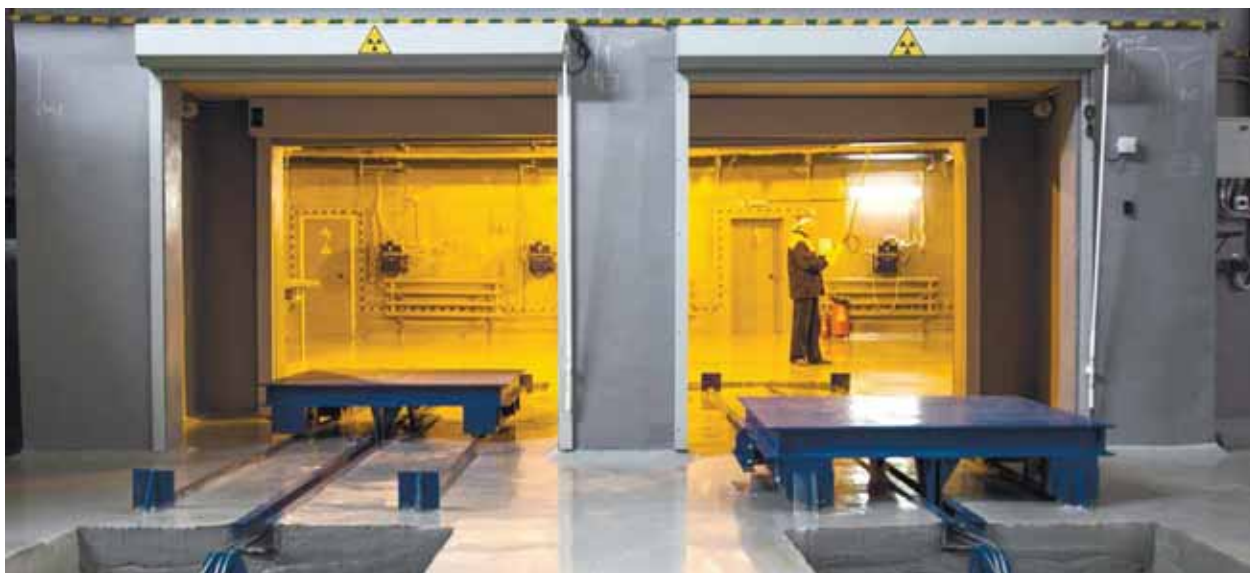
Рис. 3.6.8. Участок хранилища твёрдых радиоактивных отходов
